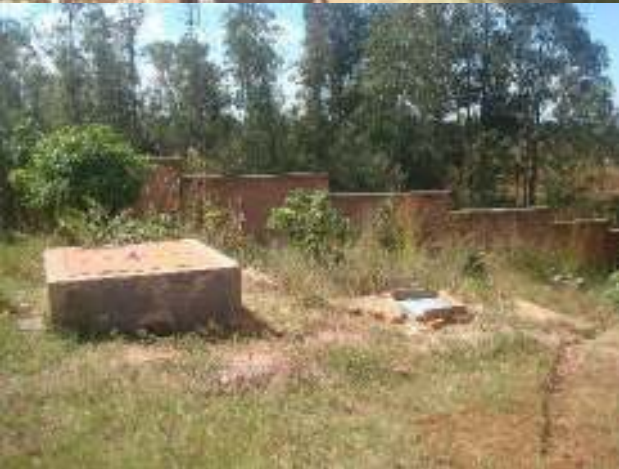
Composants de l'installation ; pompe immergée, panneaux solaires de TSARAFARITRA
